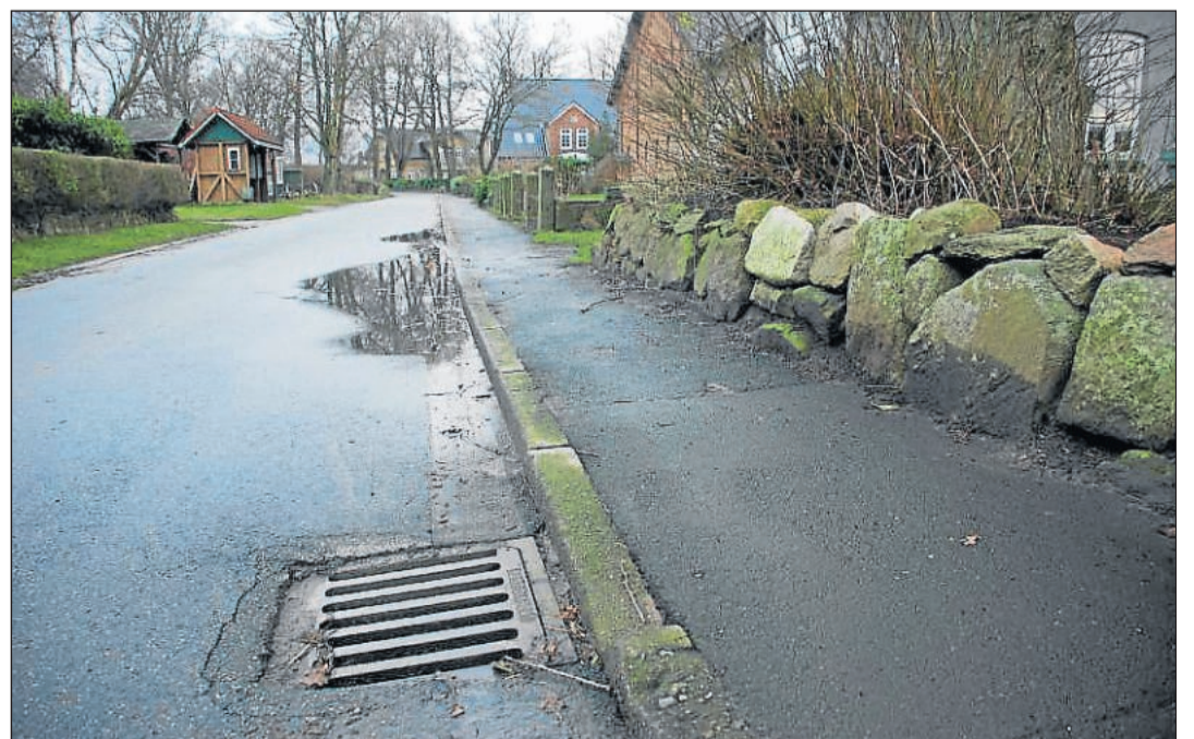
Das Oberflächenwasser läuft in der Dorfstraße an einigen Stellen nicht gut ab. Auch die Einfälle sollen dieses Jahr erneuert werden. Foto: Böttiger
